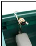
Frostschutz-Heizleitung am Ventil
