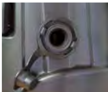
C- Rohr Anschluss für Abwasser
