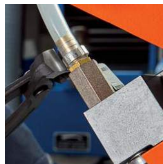
Afdichtingen van slangaansluiting aan centrale smering
