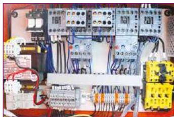
Kompletter übersichtlicher DC Schaltschrank
