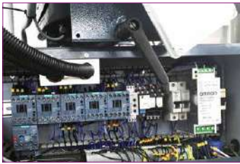
Kompletter DC Schaltschrank
