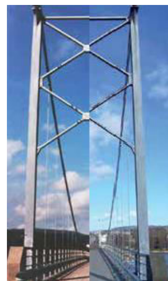
De Kalvoya Brug in Noorwegen werd in 1985 met ZINGA® behandeld. Na 30 jaar is de brug nog steeds in goede conditie.
